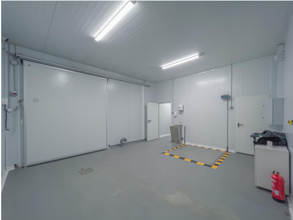
Ilustración 12 Zona de acondicionamiento. Comunica con pasillo y cámara de congelación [izquierda]
